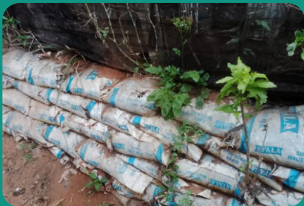
Les habitants du quartier informel de Pholani à Durban reconstruisent après les inondations de 2022. Par exemple, nous avons décidé d'utiliser la stratégie des sacs de sable pour fermer ou réparer les zones ouvertes après les inondations. Crédit : INACCT Resilience.
